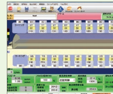
8区域或全区域风机控制 8 or all block fan control
